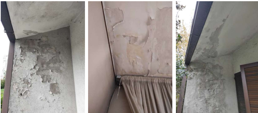
Alcuni particolari delle infiltrazioni presenti su Loggia 1, sul soffitto Camera 2, sul Portico
